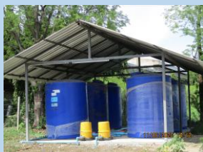
ถังสำรองน้ำใช้
